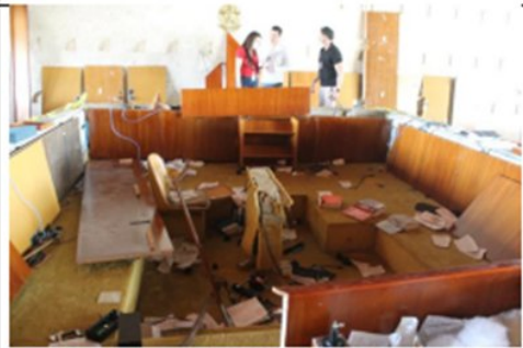
Plenário com mobiliário destruído
