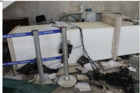
Bancadas em mármore quebradas
